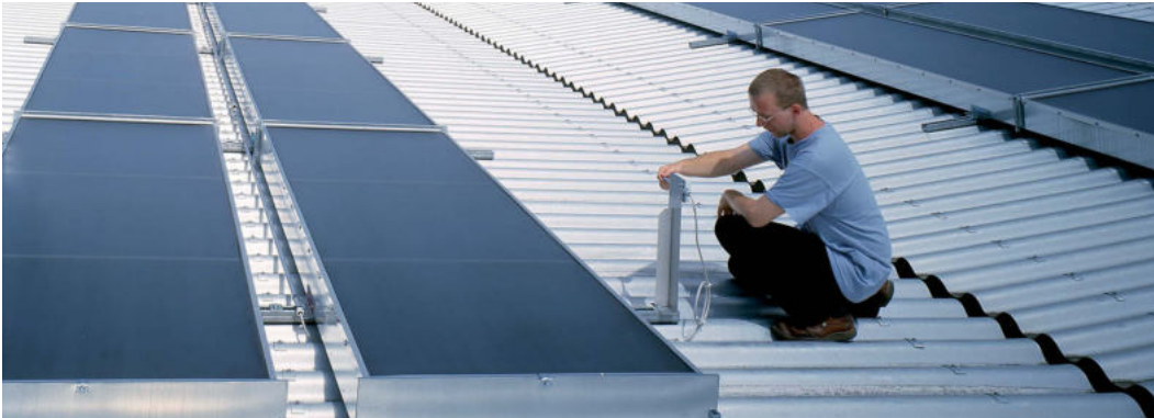
Solaranlage der IHK Freiburg © Fraunhofer ISE
