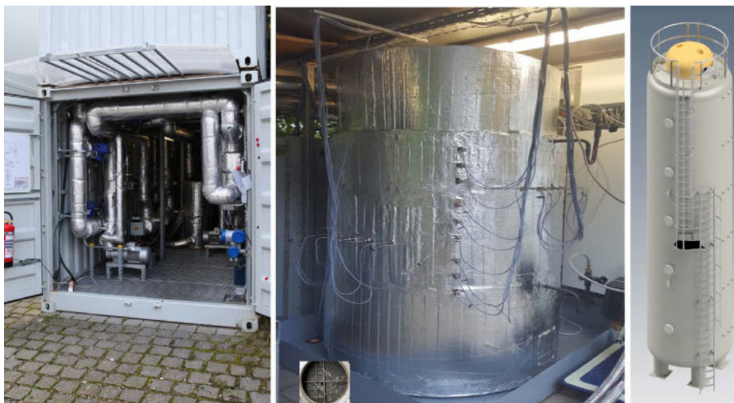
Abbildung 5 Hochtemperaturwärmespeicher für die Abwärmennutzung einer Gießerei (ZAE Bayern)
