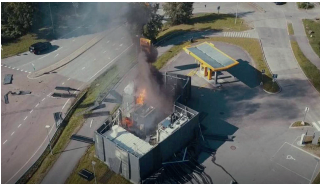
Abbildung 3 Unfall an einer Wasserstofftankstelle bei Sandvika, Norwegen, 2019 (Quelle nrk.no)
