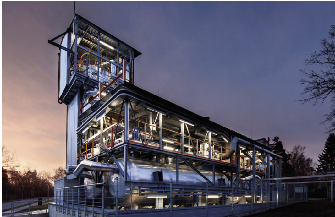
Abbildung 3 Testanlage für thermische Energie- speicherung mit Flüssigsalz (Quelle: DLR, Projekt TESIS)
