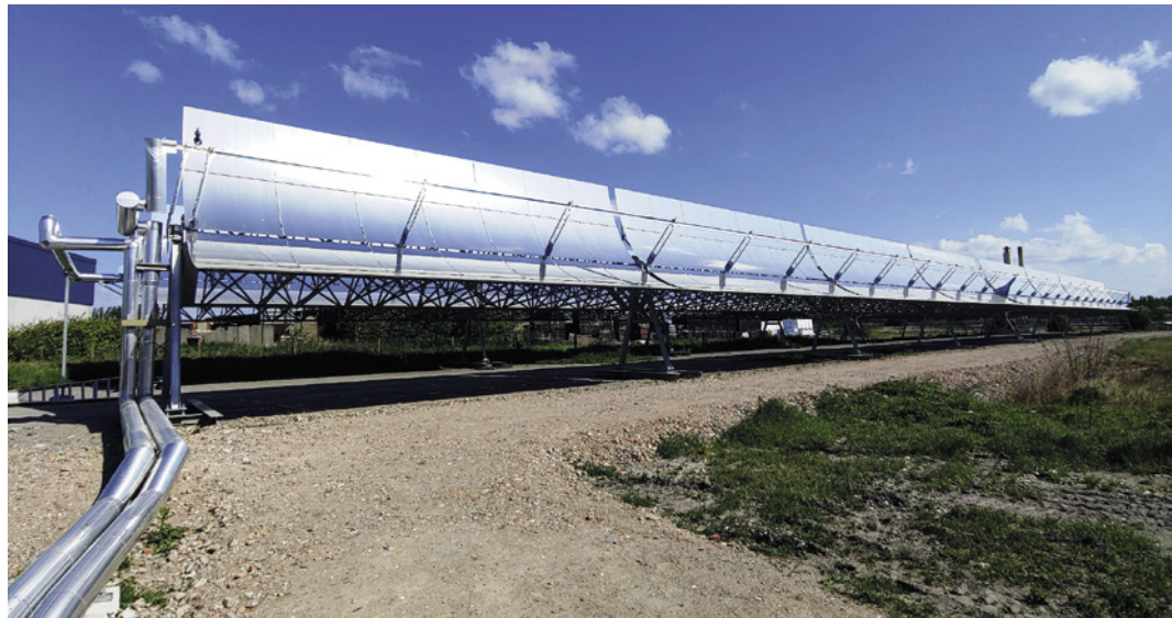
Abbildung 2 Parabolrinnenkollektor, Oostende (Foto: Solarlite)
